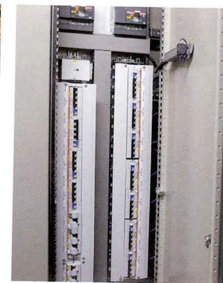
▲ Danish Crown har sikret sig en fleksibel tavleinstallation med ABB's Smisline.
